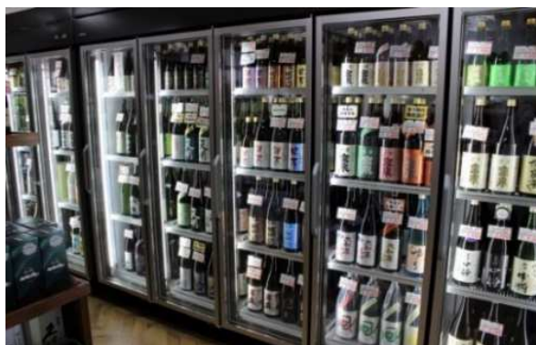
一極化した冷蔵設備
