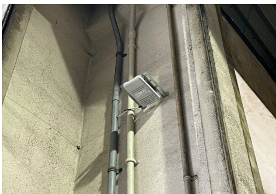
物流センター内に設置されたアクセスポイント
