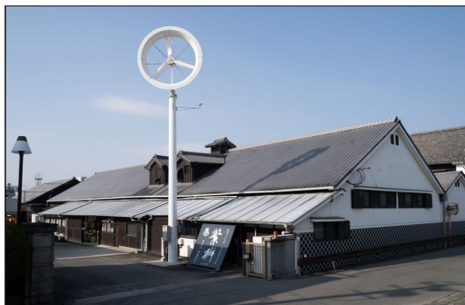
導入した風力発電設備
