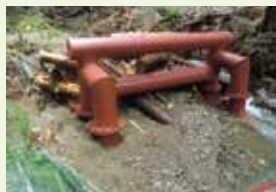
簡易流木止め施設が流木を捕捉し、下流の被害を防止
