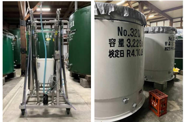
新たに導入したSFフィルター（左）及びタンク（右）
