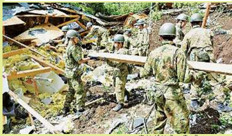
▲陸上自衛隊による災害復旧 写真提供 防衛省ホームページ
